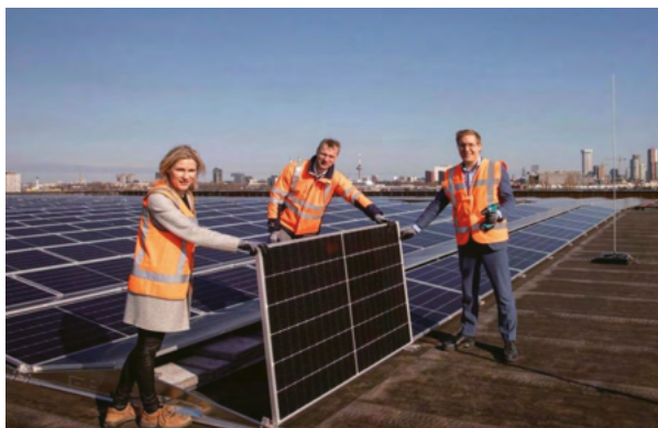
Figure 4.16. Panneaux solaires installés sur le toit du complexe Ahoy.
