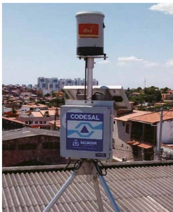
Figure 9.13: Station de surveillance météorologique pour la prévention des catastrophes
